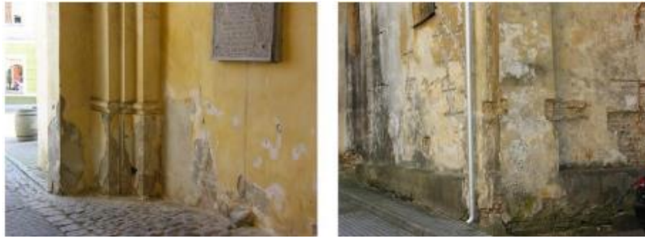
Figure 2 : exemple de l'impact de l'humidité sur des bâtiments [9].
