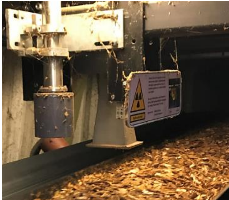
Figure 112 : technique Berthold installée au Verdo , Danemark.
